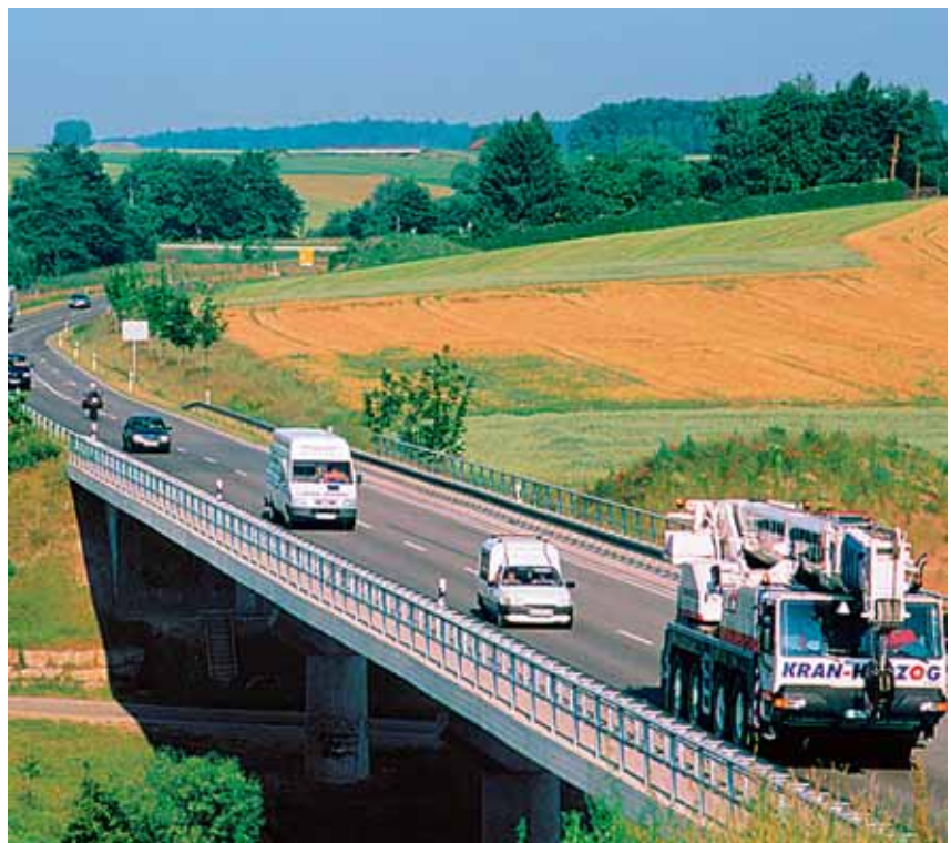
Die Nordwestumgehung überquert die Jagst mit einer 138m langen Brücke. Im Hintergrund (Bildmitte oben) ist die einzige Feldwegbrücke über die Umgehungsstrasse zu erkennen, welche die beidseitigen landwirtschaftlichen Flächen kreuzungsfrei verbindet.
